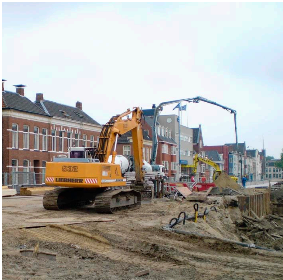
Vooraf opletten voor belendende funderingen bij 'bouw- en woonrijp maken' binnen de bebouwde omgeving.
