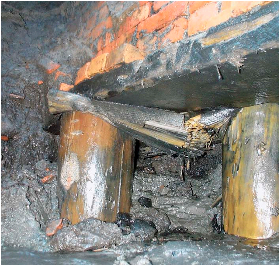
Houten paalfunderingen kunnen risico's lopen als de houtkwaliteit is afgenomen.
