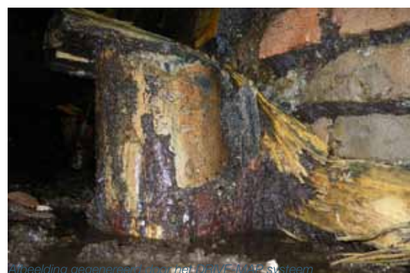
Afbeelding gegenereerd door het DIVE 3D systeem Houten fundering weggerot door vocht
